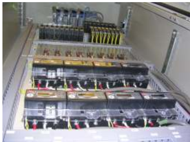
データ取得設備（コントロール部）
